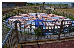
調圧水槽入口
